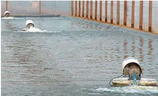
Aspirador de hélice-aireadores de bomba son dispositivos de mezcla muy buenas que son particularmente útiles para la desestratificación
